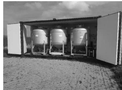
Kulfilteranlæg ved boringen (B1)
