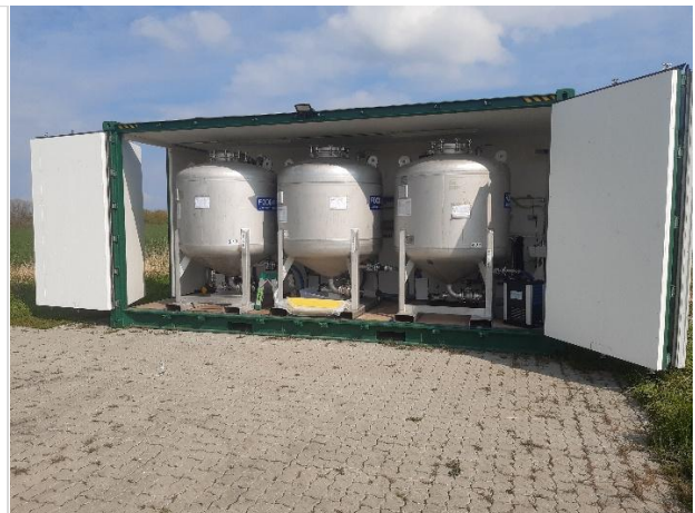
Kulfilteranlæg ved boringen (B1)
